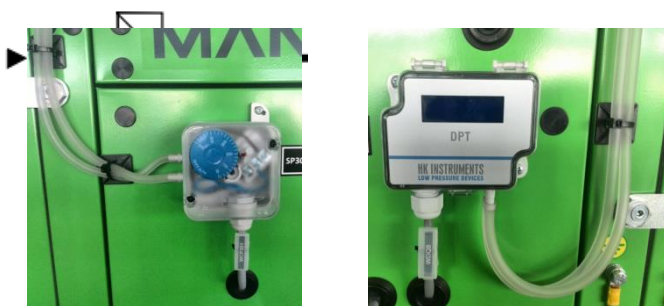
Obrázek 12 – Zapojení vstupů manostatu a instalace na plášť vzduchotechnické jednotky
