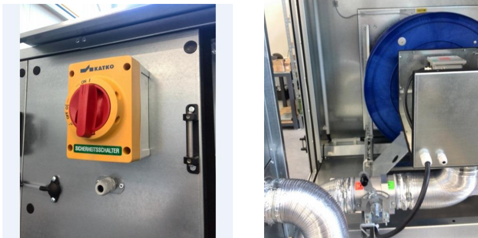
Obrázek 23 – Instalace servisního vypínače a ventilátorová komora
