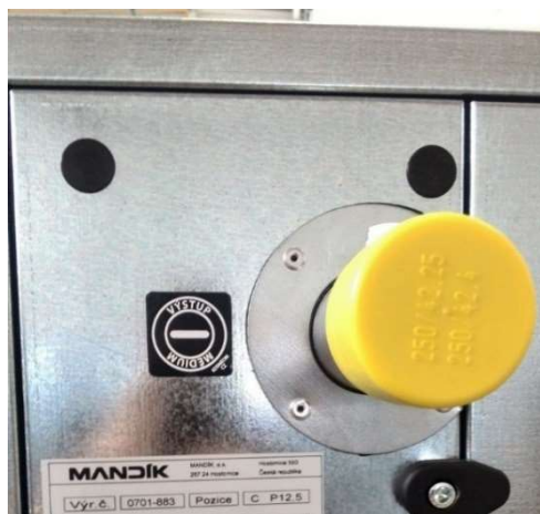
Označení vstupu do výměníku
