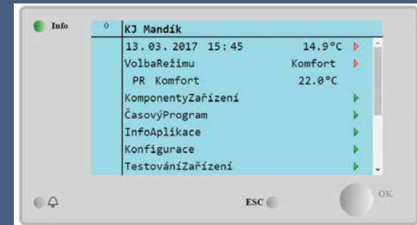
vhled obrazovky při ovládání skrze HMI@Web
